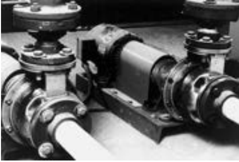
HVAC, Calefacción, Ventilación y Aire Acondicio- nado
